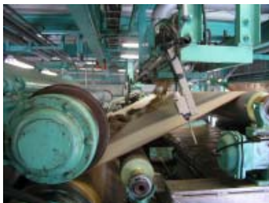
写真 1 でん粉粕のベルトプレス脱水機
