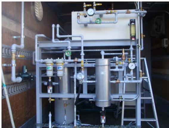
写真1 開発した精製装置の外観
