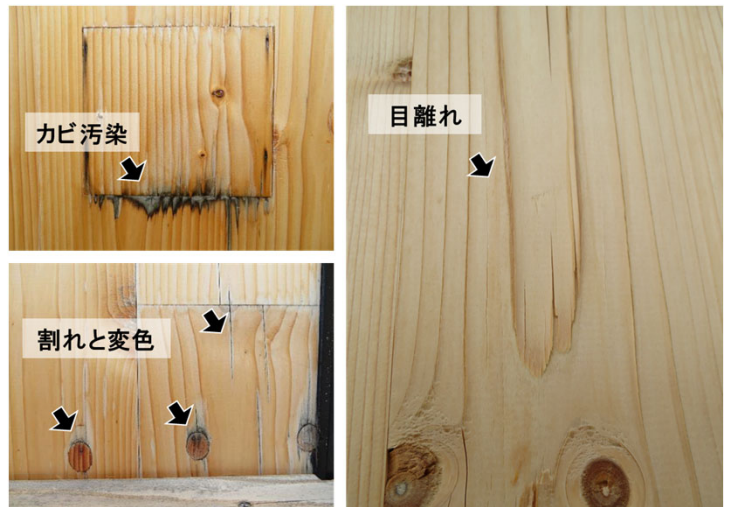
写真1 9ヵ月経過後における塗膜劣化の一例
