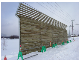
写真 2 木製高性能防雪柵
