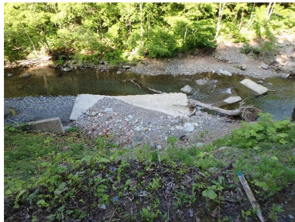
写真-12 溪岸にある擁壁の倒壊
