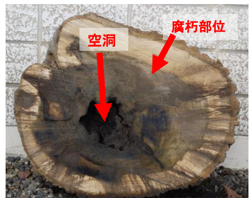
写真-1 外観からは判断できない心材腐朽
