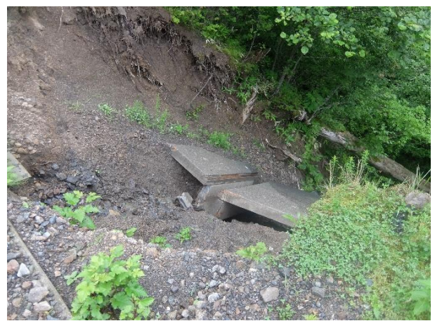
写真-5 崩落した明渠
