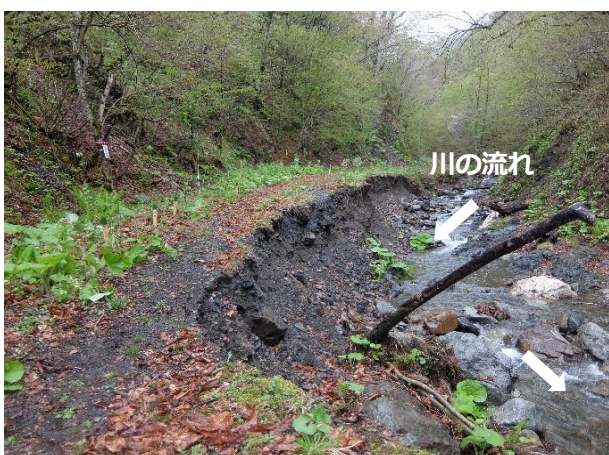
写真-6 溪岸侵食（のり面を直接侵食）
