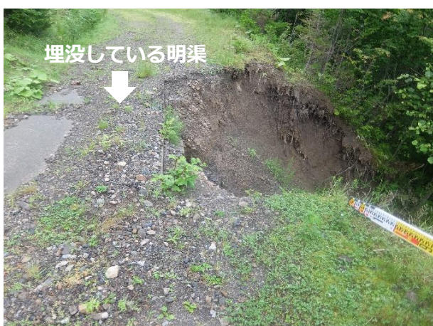
写真-4 崩落タイプ
