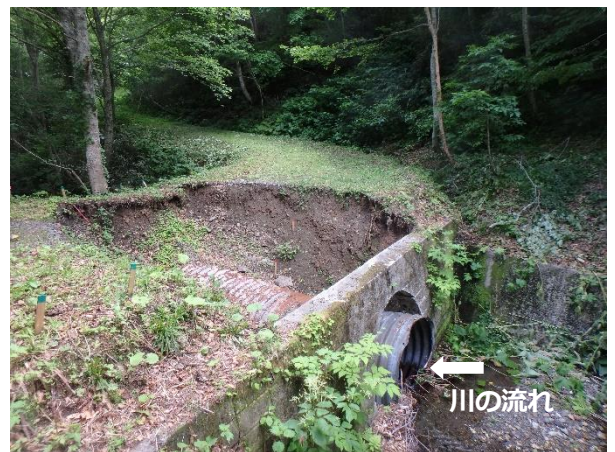
写真-10 谷をまたぐ道路における上流側からの侵食
