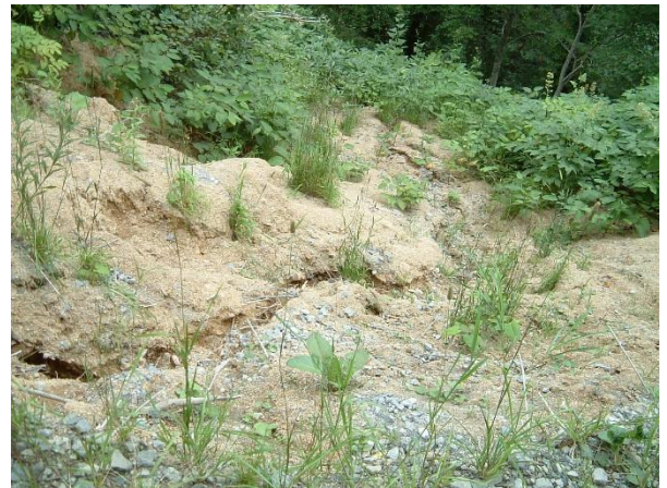
写真-8 盛土のり面崩壊の裸地にできたガリ
