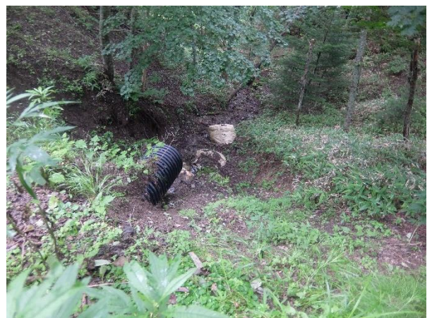
写真-3 横断排水吐口にできたガリ侵食
