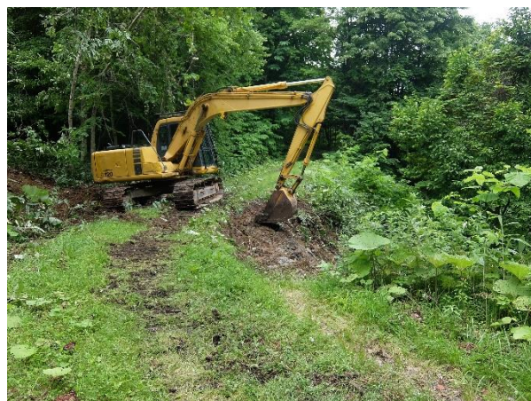
写真-16 盛土のり面崩壊の復旧(つづき)
