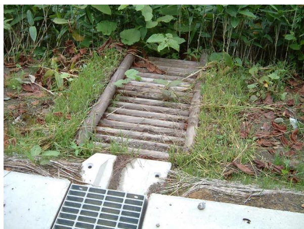
写真-17 横断排水の吐口に設けられた水たたき
