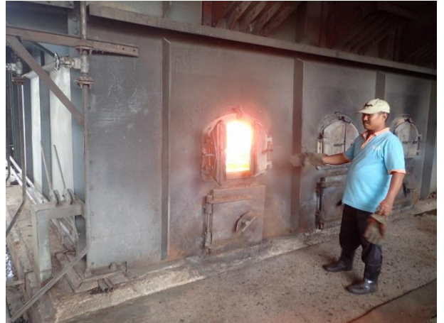
写真5 バイオマスボイラー
