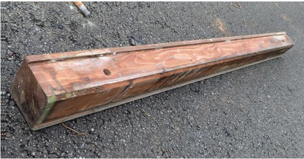
写真3 山形鋼材の接触面
