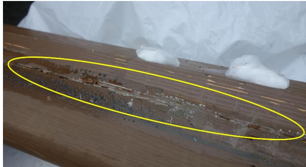
写真4 実用化製品に発生した腐朽部位 (腐朽幅3~5mm×長さ200mm程度)
