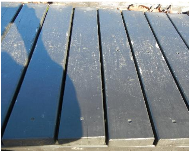
写真 施工後7年5か月経過した木道の干割れ発生状況（上段：施工当時，中段：無処理材，下段：常圧気相アセチル化材）
