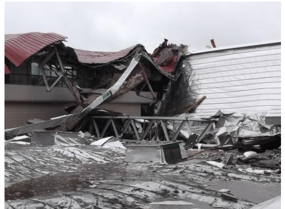
雪荷重により倒壊した鋼構造建築物の事例
